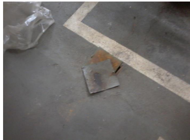
Figura 8. Tampas irregulares da Oficina Mecânica.
