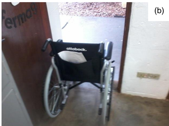
Figura 10. (a) condições acessíveis (b) inexistência de rampas para cadeirantes no laboratório de Enfermagem
