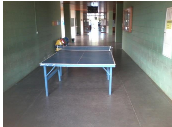
Figura 14. Mesa de Tênis de Mesa obstruindo a passagem
