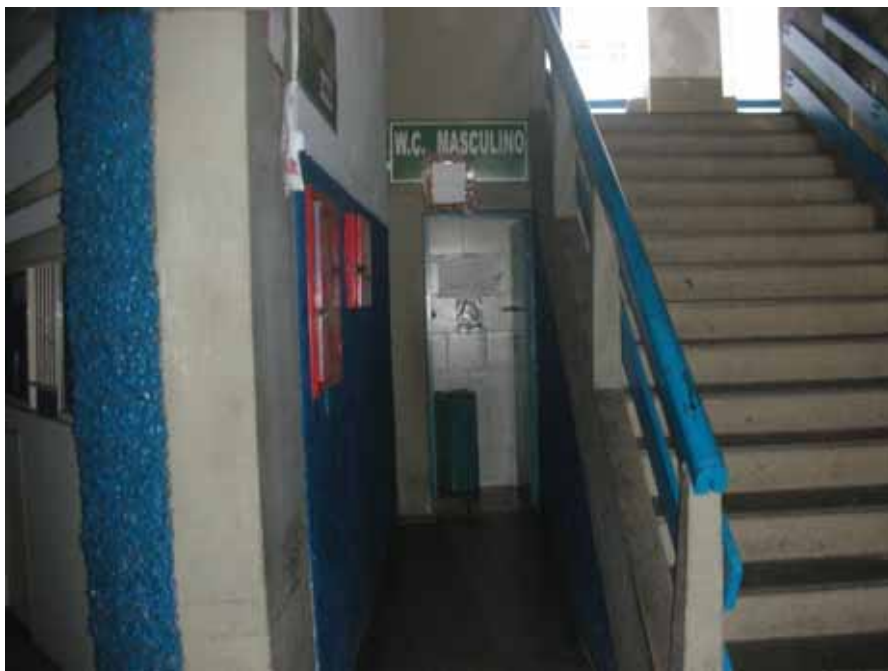
Figura 09 - Portas muito estreitas impedindo o acesso de cadeirantes
