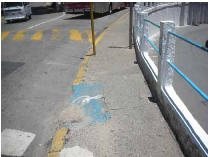
Figura 14 - Falta de manutenção de rampas e calçadas.
