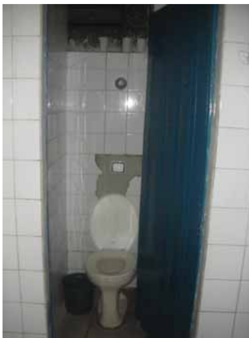
Figura 08 - Cabine sanitária demasiadamente pequena, cujas portas abrem para dentro
