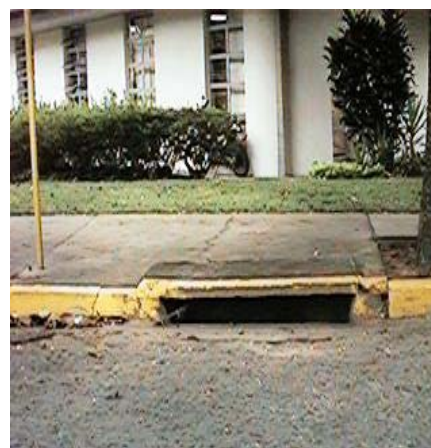
Figura 1. Grades em bueiros.
